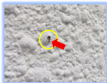
塗装が浮き、膨れ破れた
