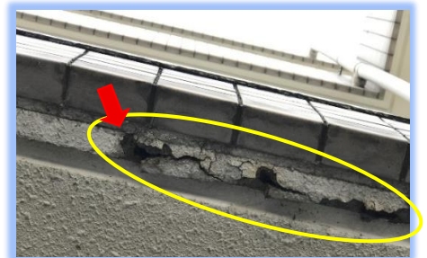
タイルの内側のヒビ・割れ
